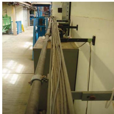
(d) Foundation Plate and Wall Mounted Support Frames
